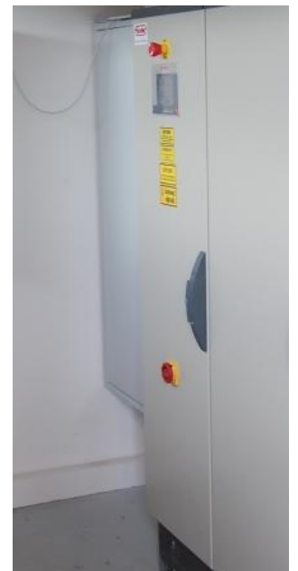
Распределительный шкаф с сенсорной панелью
