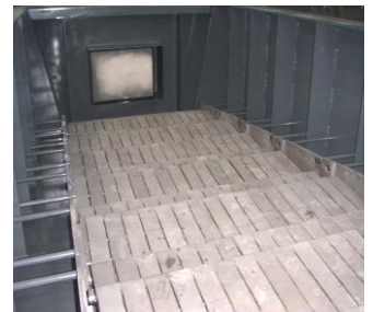
Топка с подвижными колосниками
