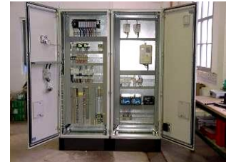
Вид изнутри распределительного шкафа
